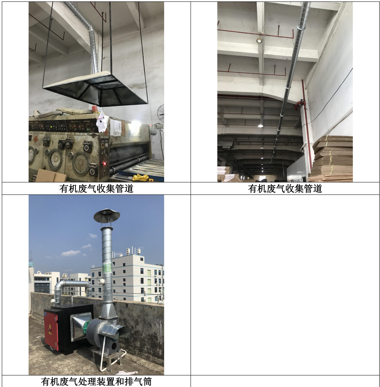
图4-1 废气收集处理装置
