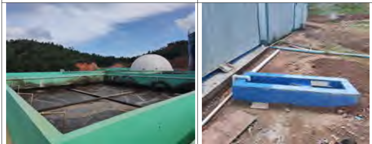
污水治理设施
