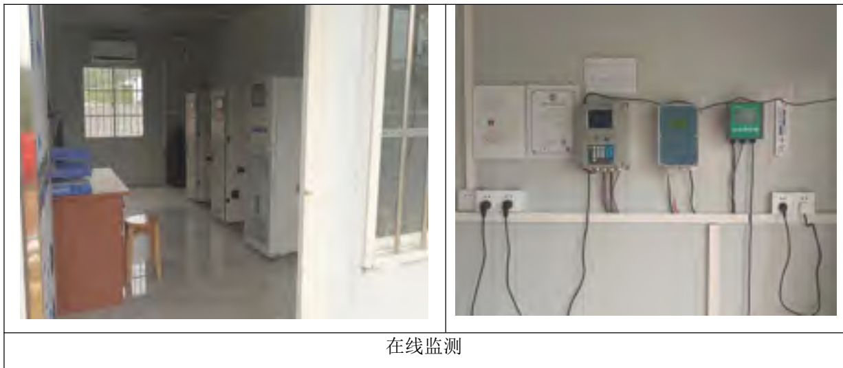
图 4-2 现场污染治理设施图
