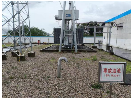
图 6-4 事故油池(应急措施)
